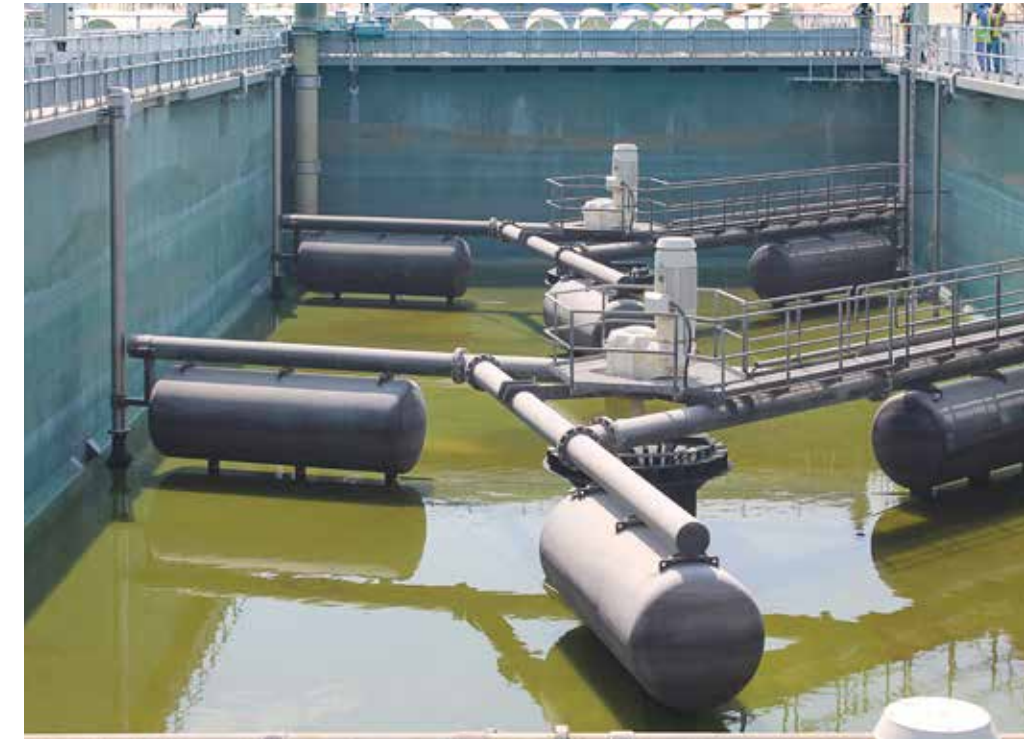
INSTALLATION DE DÉCHARGEMENT DES PÉTROLIERS AL SAJA'A ET STATION D'ÉPURATION DES EAUX D'ÉGOUTS Sharjah, EAU
